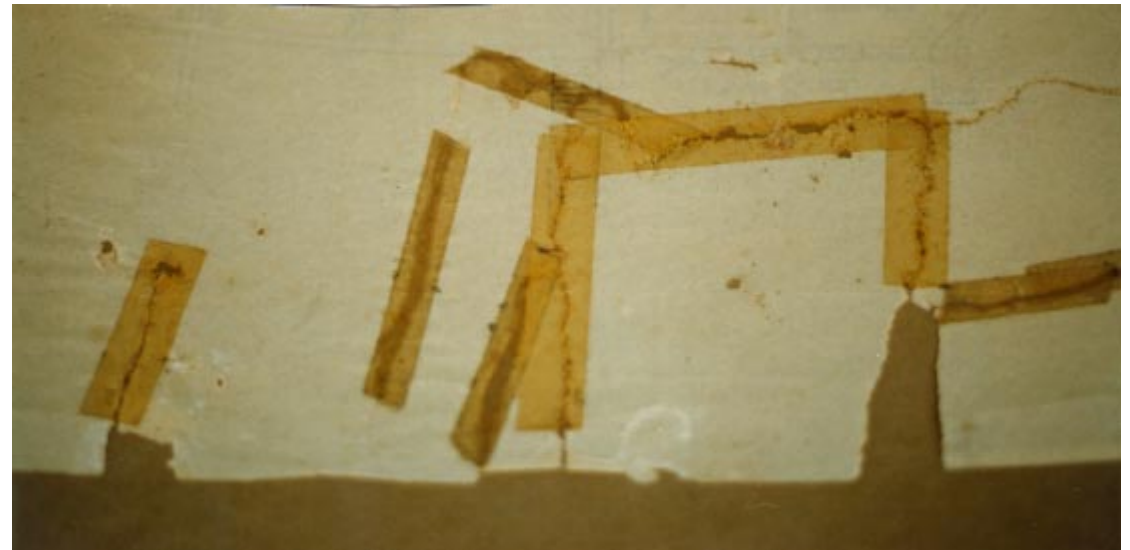
imagem 8 - Intervenções inadequadas: fita adesiva
